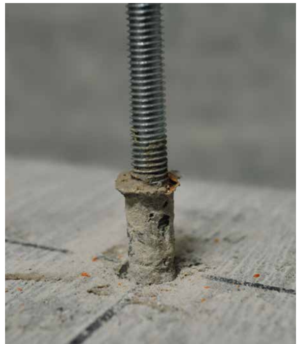
Die Staubschicht zwischen Ankerstange und Bohrlochwand ist deutlich sichtbar.
